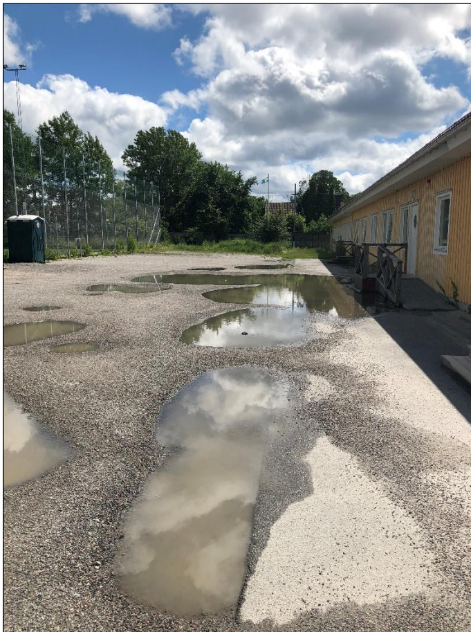
Figur 3 Stående vatten på ytan mellan konstgräsplanen och Näsbylundens förskolebyggnad. Bild tagen under platsbesök 2020-06-26.
